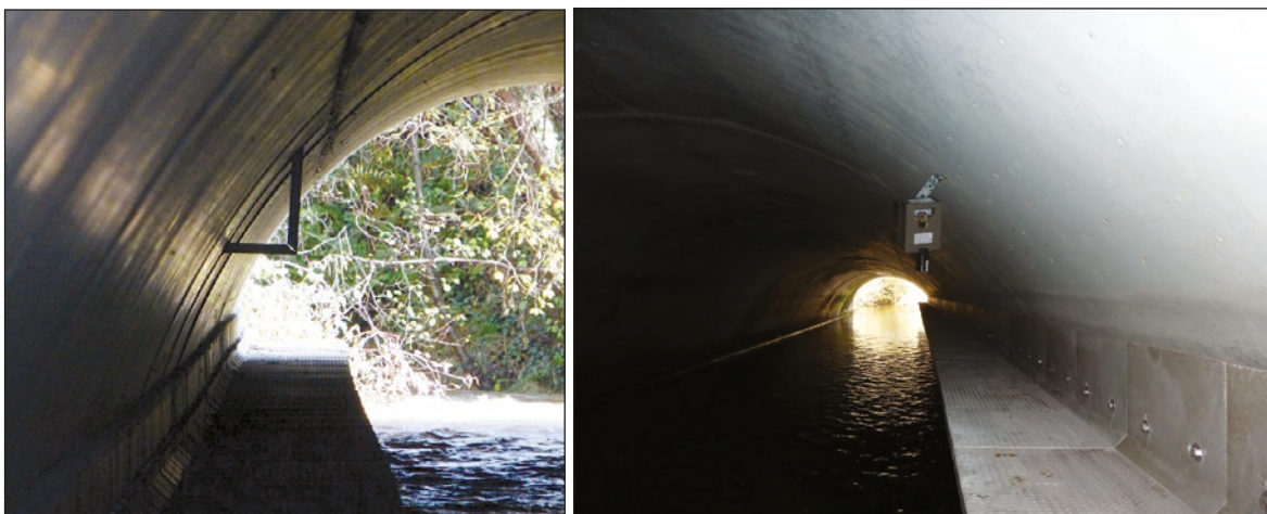
Photos n°26 : Fixation du « L » en vue du suivi écologique post-aménagement (à gauche) et appareil fixé sur une cornière simple sans possibilité de passage du câble de protection. (©VINCI Autoroutes).
