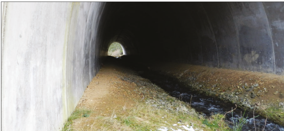
Photo n°105 : Ouvrage hydraulique de très grandes dimensions avec banquette en terre sur l'A89. (© FRAPNA Loire, VINCI Autoroutes).
