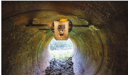
Photo n°30 : Piège photographique dans un écoduc de l'A10. (@A. Orseau, LPO France).
