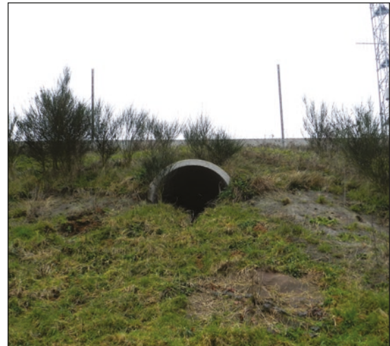
Photo n°37 : Écoduc de type I sur l'A89. (© FRAPNA Loire, VINCI Autoroutes).
