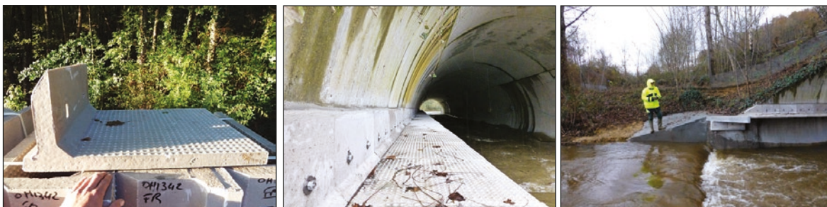
Photos n°24 : Encorbellement en béton polymère, encorbellement achevé dans l'OH et raccordement offrant une possibilité de passage depuis le pied et le haut de berge et ne générant pas un point dur à l'écoulement (de gauche à droite). (© VINCI Autoroutes).
