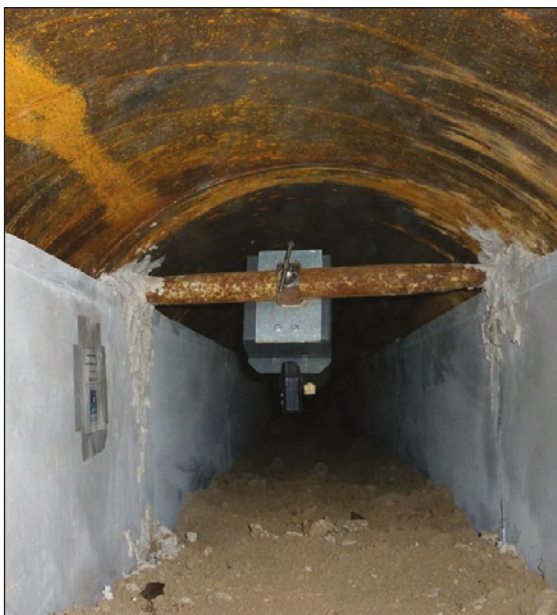
Photo n°75 : Configuration d'une buse circulaire adaptée aux déplacements des amphibiens. (© LPO Drôme, VINCI Autoroutes).
