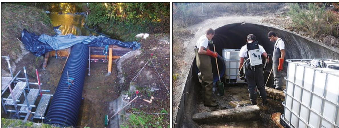
Photos n°27 : Dérivation par busage et batardeaux (on note la matérialisation du raccord à la berge sur la photo), pêche électrique préalable réalisée par une FDPPMA (de gauche à droite). (©VINCI Autoroutes).
