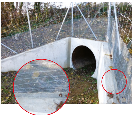
Photos n°18 : Repositionnement semi-enterré du grillage renforcé (haut), jointure au mortier du grillage autour de la tête (bas). (© VINCI Autoroutes).
