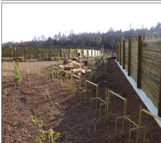
Photos n°13 : Alignement de blocs anti-intrusion (haut) et barrière métallique anti intrusion engin, mais perméable à la faune sur un écopont (bas). (© VINCI Autoroutes).
