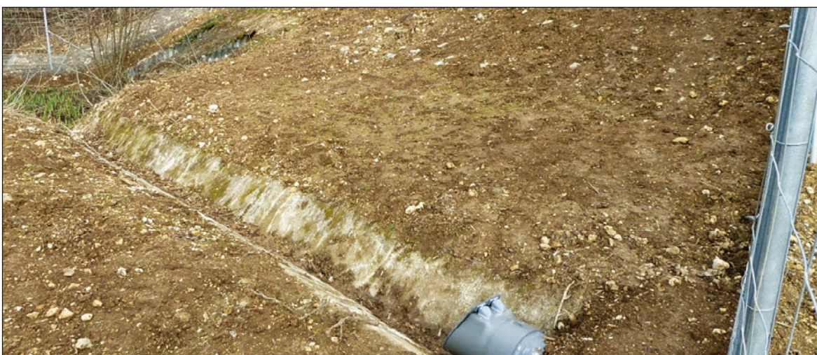
Photo n°19 : Dispositif de type clapet adapté dans certains cas uniquement (clôture franchissant un fossé). (© VINCI Autoroutes).
