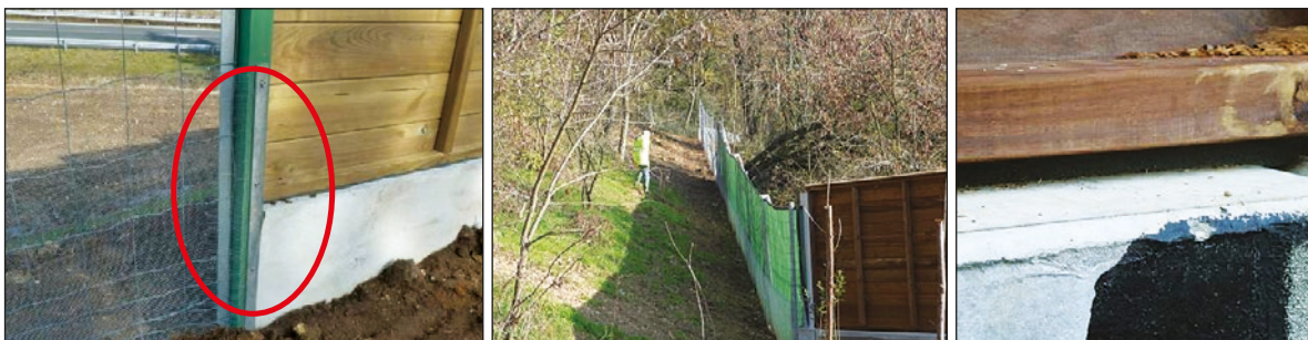
Photo n°10 : Raccord correct, brise-vue avec jambes de force et joint souple sous écran (de gauche à droite). (@VINCI Autoroutes).
