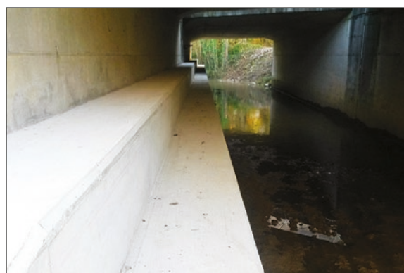
Photo n°10 : Banquette double marche à l'intérieur d'un ouvrage hydraulique. (© VINCI Autoroutes).
