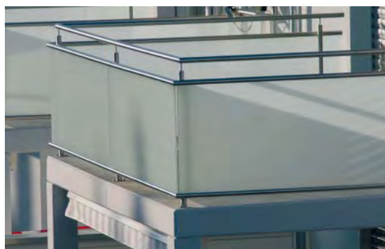
Les balustrades de balcon translucides ne sont pas un danger pour les oiseaux.
