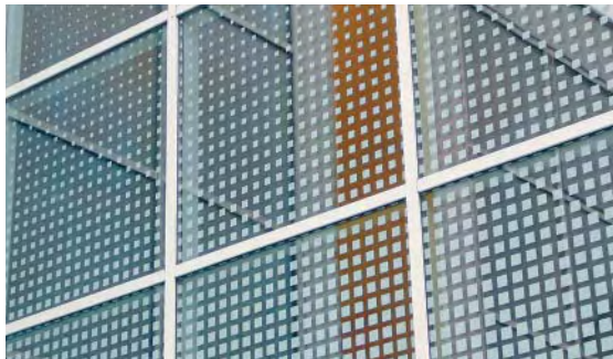
Trame dont le taux de couverture diminue progressivement vers le haut. Efficace s'il n'y a pas de grands arbres à proximité.
