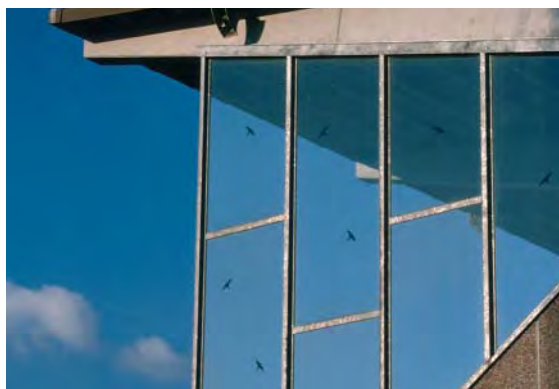
Vitrage de protection contre le vent avec un marquage inefficace fait de silhouettes de rapaces
