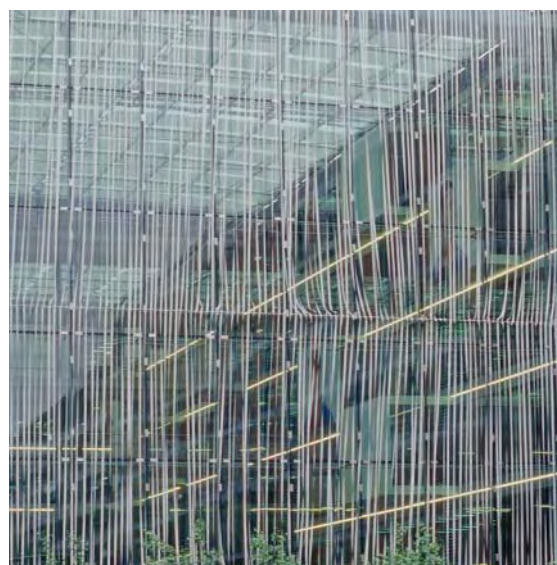
Des bandes en plastique claires ont été fixées devant ce bâtiment comme solution de secours.
