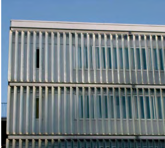
Des lamelles verticales ou horizontales produisent une ombre et divisent la façade. Les oiseaux voient qu'il s'agit d'un obstacle.
