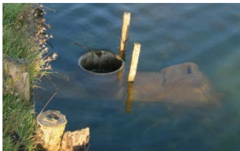
Ouvrage hydraulique de type PVC à clapet anti-retour avec surverse
